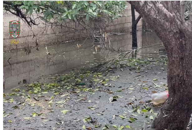
تدمير شبكة تصريف مياه الامطار
